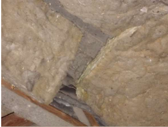
Abbildung 34: Mattendämmstoff mit Lücken verlegt
